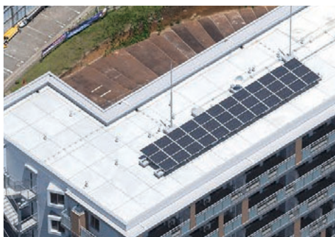
JKK住宅の太陽光発電パネル
